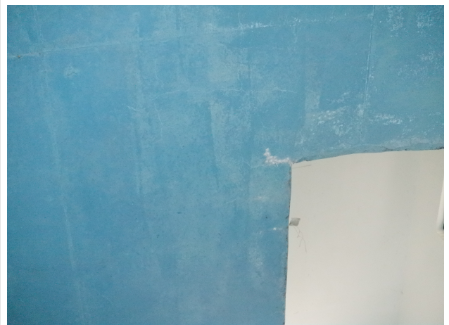
배수지1지 상부슬래브 백태
