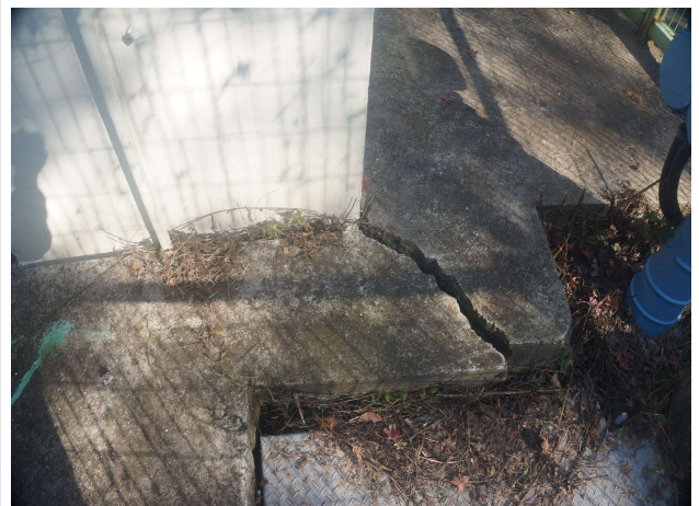
검수실 외부 바닥 기초 이격
