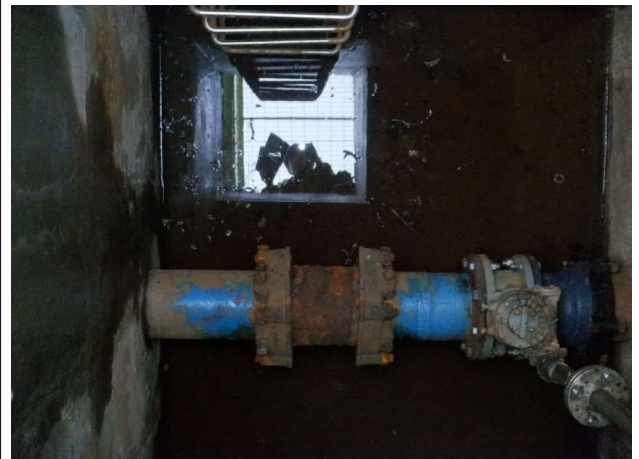
유입밸브실 바닥슬래브 체수
