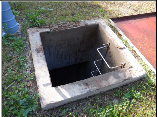
유출밸브실 출입구(외부) 모르타르 파손
