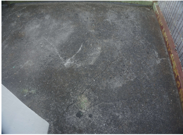
검수실 외부 바닥 기초 균열(0.3mm이상)
