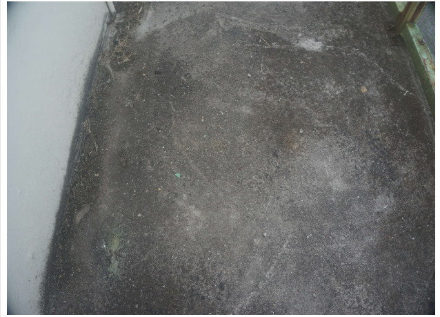
검수실 외부 바닥 기초 균열(0.3mm이상)
