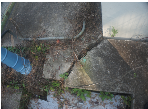
검수실 외부 바닥 기초 이격
