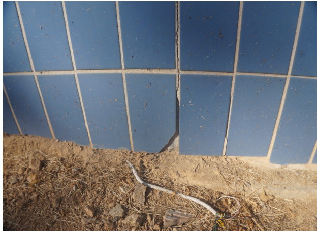
전기실 및 관리동 외부 타일 파손
