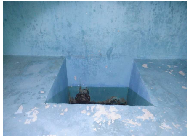
배수지 내부 안전난간 미설치
