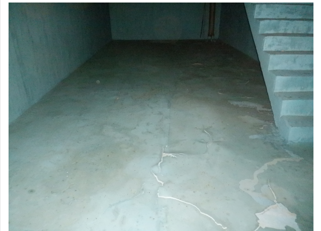
배수지1지 바닥슬래브 도장박리, 박락
