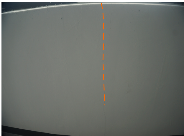
전기실 및 관리동 내부 벽체 균열(0.3mm미만)
