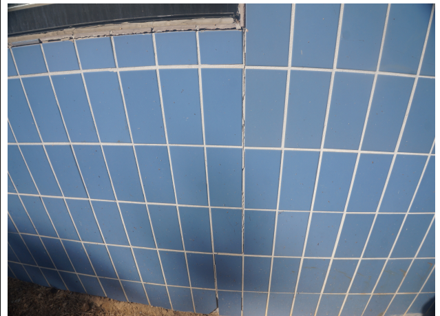
전기실 및 관리동 외부 타일 줄눈부 균열
