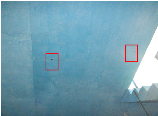
배수지1지 상부슬래브 녹
