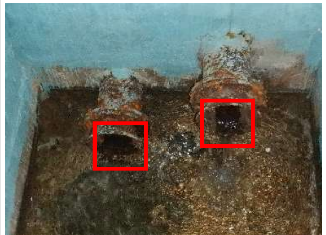
배수지1지 배관설비 차수불량
