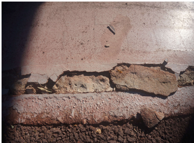
전기실 및 관리동 외부 바닥 파손
