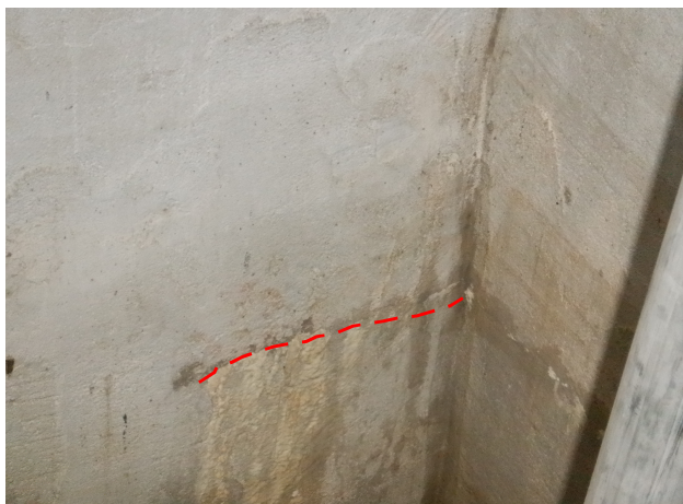
유출밸브실 벽체 균열(0.3mm미만)
