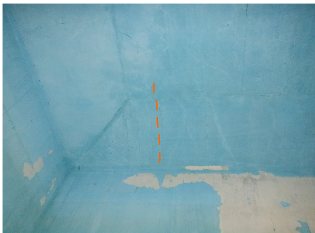
배수지1지 상부슬래브 균열(0.3mm미만)
