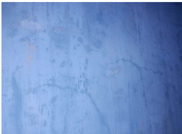
배수지2지 벽체 망상균열
