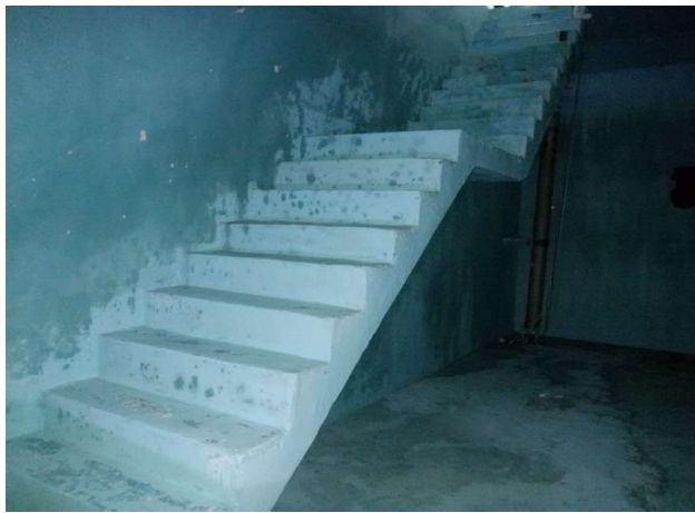
배수지 내부 안전난간 미설치
