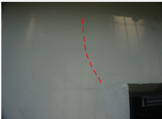
검수실 외부 벽체 균열(0.3mm미만)
