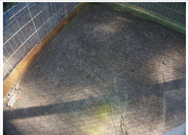
검수실 외부 바닥 기초 균열(0.3mm이상)
